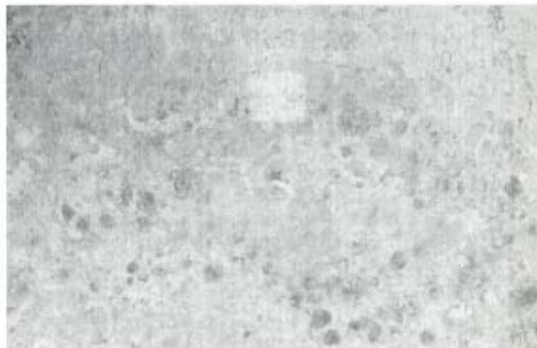
4. Detalle de la superficie lateral, donde destacan las manchas producidas por el ataque orgánico y la cata con el engobe blanco.
