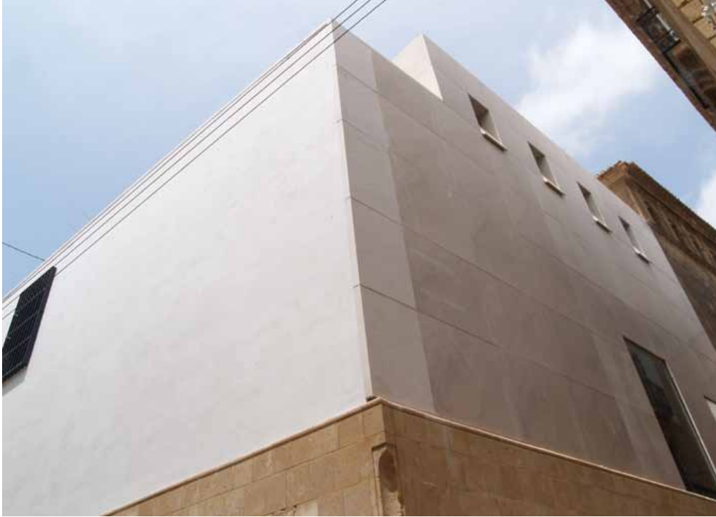
Fig. 2. Edificio de ampliación del Museo de Xàbia. Perspectiva desde la calle Major.
